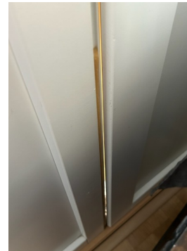
Utetthet mellom balkongdør og karm.
