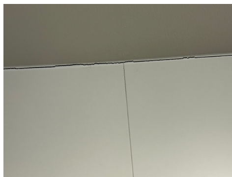
Tørkesprekker i fuger.
