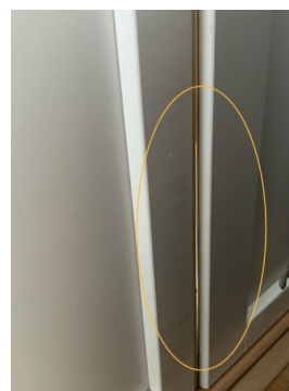
Utetthet mellom balkongdør og karm.
