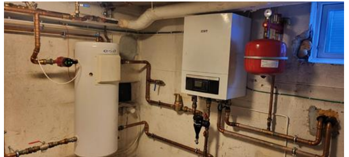
Tekniske anlegg, VVS anlegg (Sjekkpunkter utover det som er inkludert i andre rom) - [varmepumpe og varmtvnsbereder]
