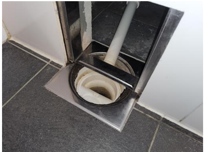
Våtrom - [Sluk på bad 1]
