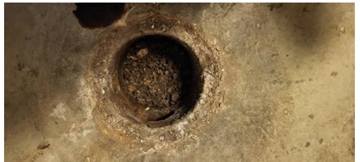
Tekniske anlegg, VVS anlegg (Sjekkpunkter utover det som er inkludert i andre rom) - [Sluk på fyrrom]
