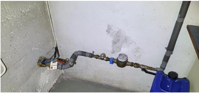
Tekniske anlegg, VVS anlegg (Sjekkpunkter utover det som er inkludert i andre rom) - [Stoppekran og vannmåler ]
