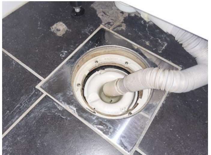
Våtrom - [Sluk på bad 2]
