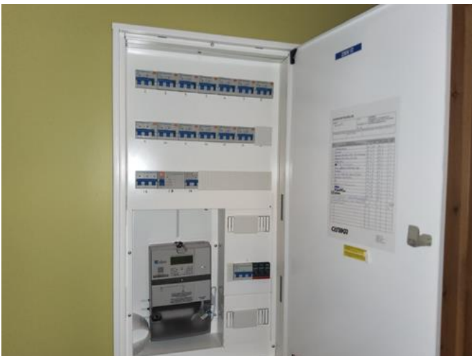
Elektrisk anlegg - [Sikringskap]
