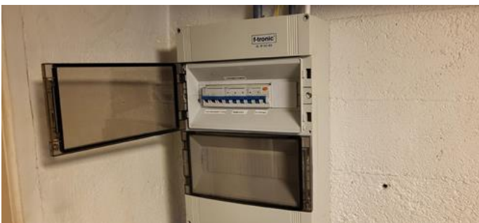
Elektrisk anlegg - [Sikringsboks]
