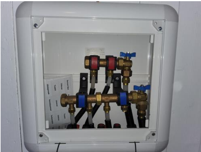
Våtrom - [Fordelerskap for rør-i-rør system bad 2]
