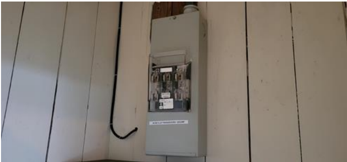
Elektrisk anlegg - [Sikringsboks]
