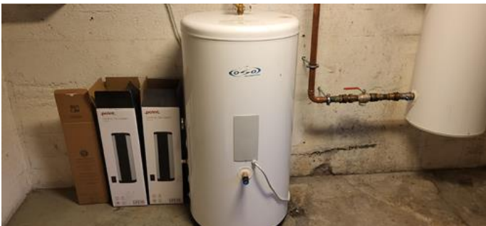
Tekniske anlegg, VVS anlegg (Sjekkpunkter utover det som er inkludert i andre rom) - [Varmtvnsbereder]
