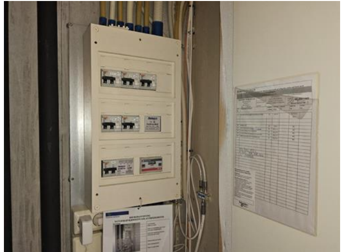
Elektrisk anlegg - [Sikringskap ]
