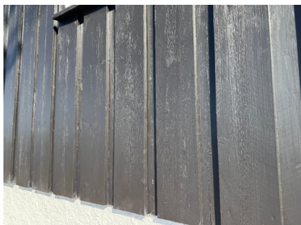
Stedvis sprekker i kledning
