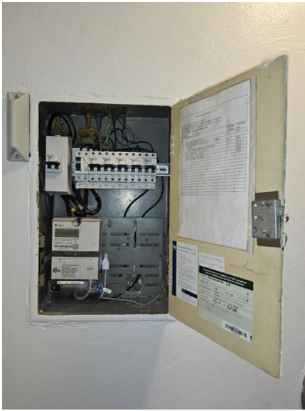
Elektrisk anlegg - [Sikringskap ]
