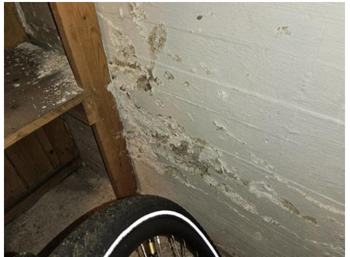
Andre forhold - [Kalkutslag i boden i underetasjen. ]
