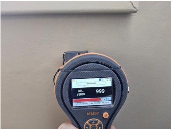
Øvrige rom [eksklusive spesialrom] - [Fuktsøk under vindu i stuen. ]
