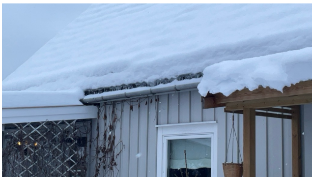
Noe ising ved takfot.
