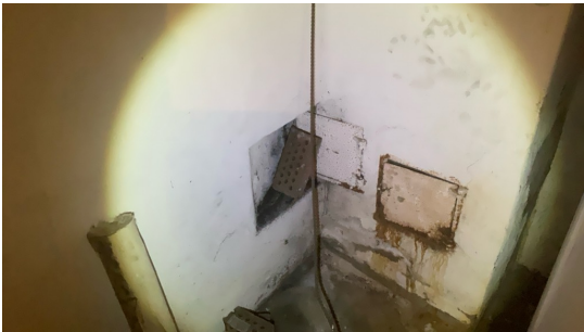
Bek-lekasje under feiluke kan tyde på at det bør fjernes aske etter feiing.
