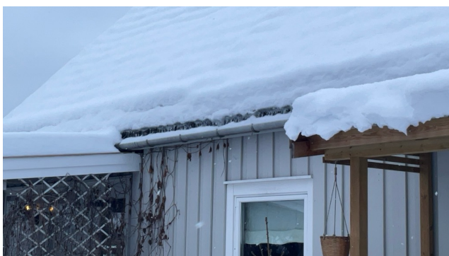
Noe ising ved takfot.
