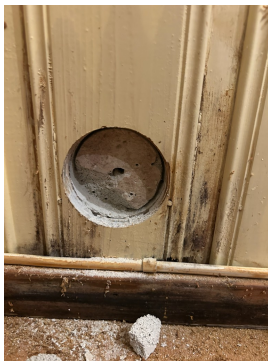
Det er ved hulltaking registrert forhøyede fuktverdier i trepanel og kjellermur.
