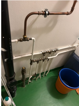
Vannledninger med fordelerstokk på vaskerom.
