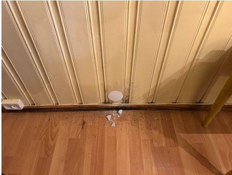
Innvendig panel i tilnytning påforet yttervegg mot grunnen har synlige fuktmerker.
