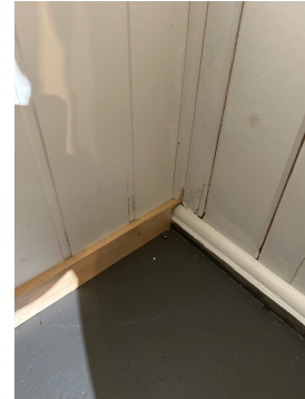
Veggplater har svellet i bunnen på grunn av fukt.
