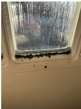
Trolig forekommet kondensering over tid, i kombinasjon med dårlig vedlikehold.
