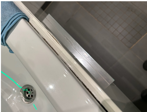
Fuktskader på baderomsinnredningen.
