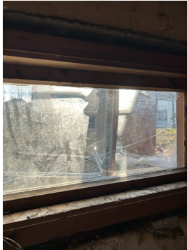
Kjellervindu er punktert og sprekt glass.
