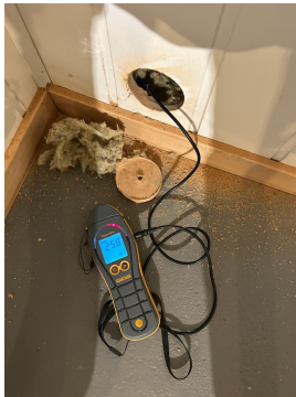
Fuktmåling i påforet kjellervegg.
