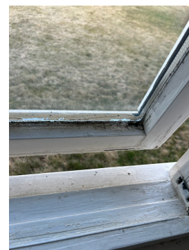
Tydlig tegn på innvendig kondensering og mangelfullt vedlikehold.
