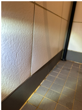
Baderomsplater i dusjsjonen har tegn på fuktskader i bunn.
