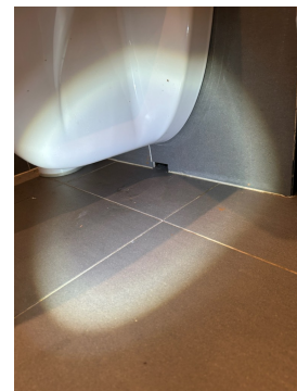
Synliggjøring av lekkasjevann er tilfredstillende under veggmontert toalett.
