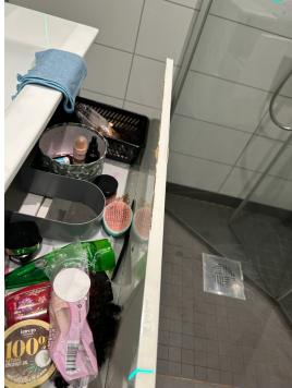
Fuktskader på baderomsinnredningen.
