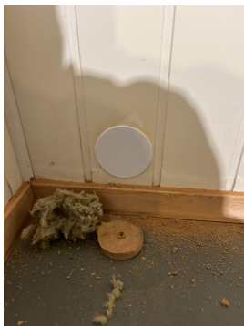
Veggplater har svellet i bunnen på grunn av fukt.
