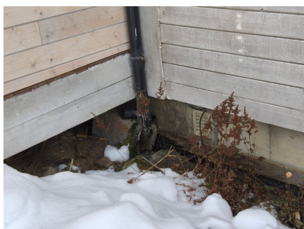
Nedløpsrør mangler nedre del og bortledning av takvann.
