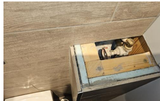
Innvendig stoppekrane - Hovedstoppekrane.
