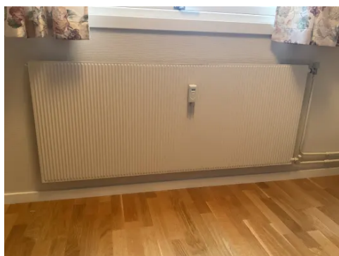
Boligoppvarming med vannbåren varme til radiatorovner
