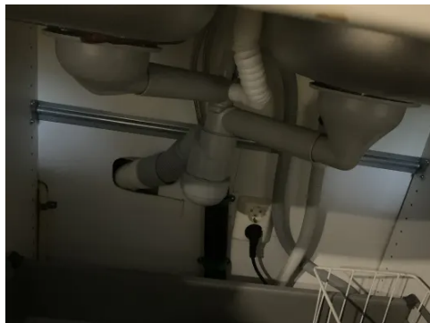
Synlig innvendig avløpsrør med PVC-plast
