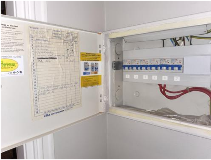
Beskrivelse - [Sikringskap med kursfortegnelse.]
