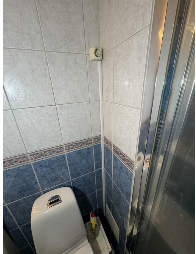
stoppekran er bak inspeksjonsluke
