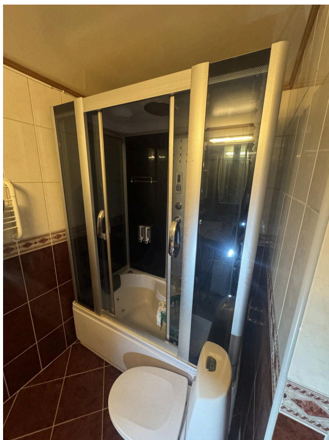
Dusjkabinett på stort bad, sluk ikke tilgjengelig.
