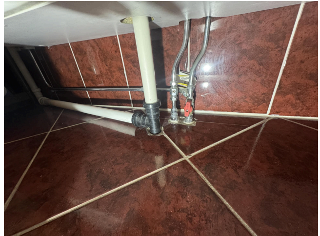
Gjennomføringer av rør i gulv. tilfredstilles ikke dagens krav.
