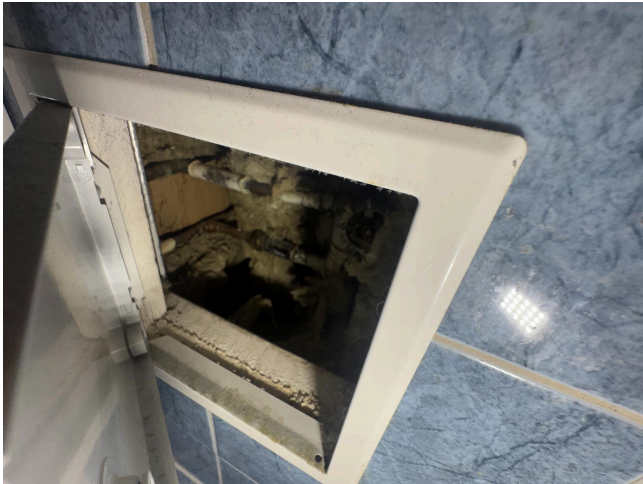
Stoppekran på lite bad ved siden av WC
