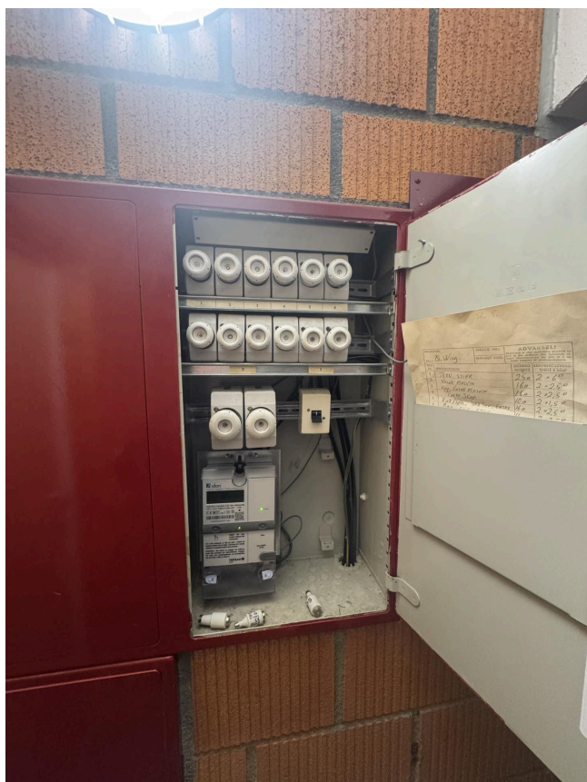
Sikringskap i gang, skrusikringer
