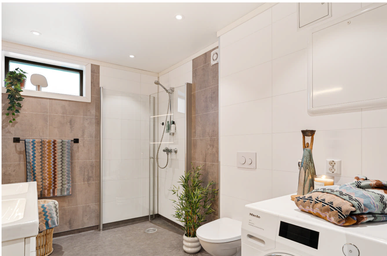
Bad med TG1. Mekanisk avtrekksvifte og inspeksjonsluke til rør-i-rør.
