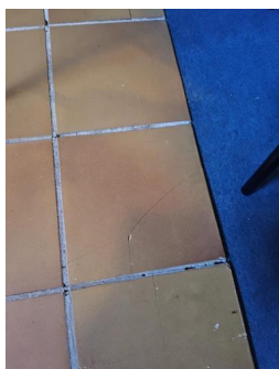
Overflate gulv - Løse/skadde fliser.
