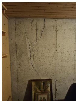
Overflate vegg - Sprekk i grunnmur.
