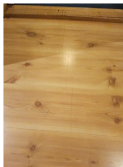
Overflate gulv - Ufagmessig utførelse av gulvflater.
