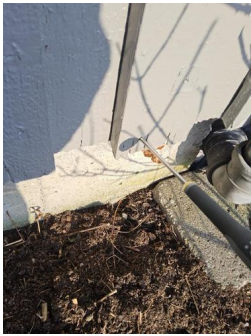
Ytterkledning (fasademateriale, vannbord, utvendig listverk, o.l.) - Råteskader.
