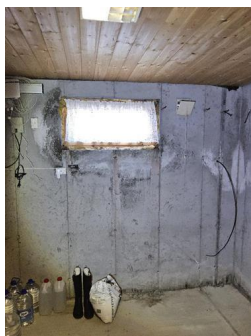
Overflate vegg - Salt/kalkutslag.
