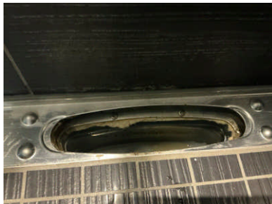
Sluk i dusjsone.
