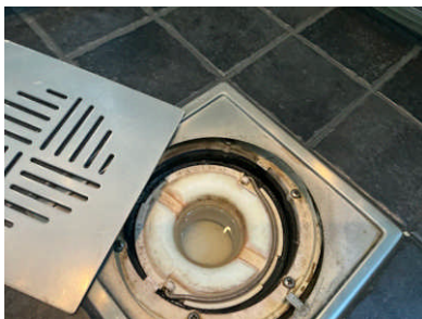
Sluk i dusjsone.
