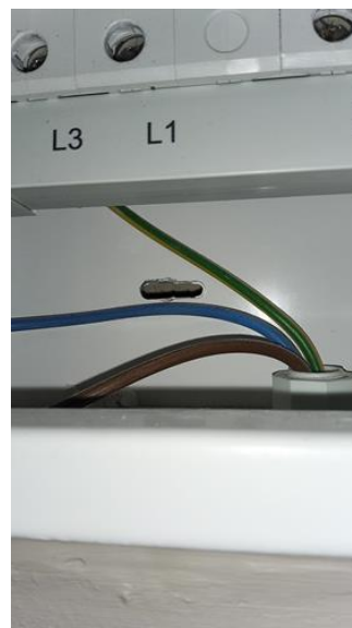
Elektrisk anlegg - [Åpninger i sikringsskap]
