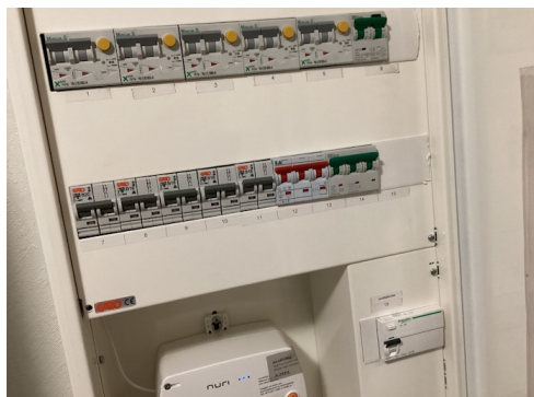
Bilde av sikringskap.
