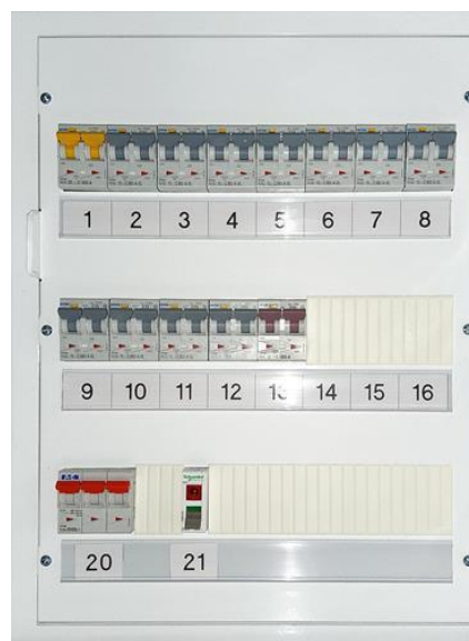
Elektrisk anlegg - [Sikringsskap]
