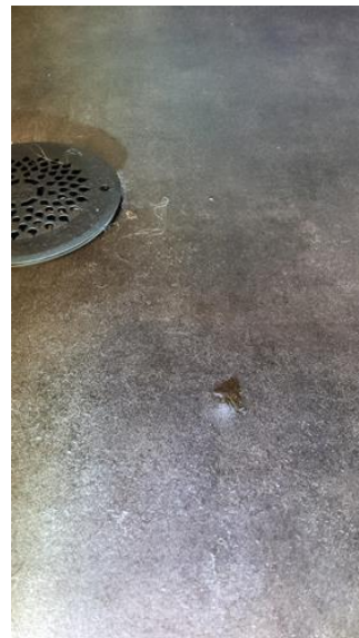
Overflater gulv - [Skade i gulvbelegg på bad]
