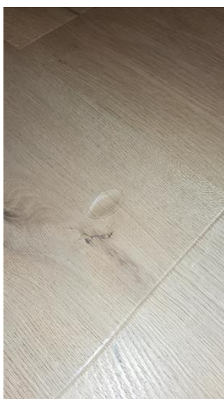
Overflater gulv - [Skade i laminat på kjøkken]
