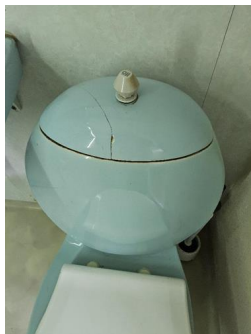
Sanitærutstyr og innredning - Toalett.
