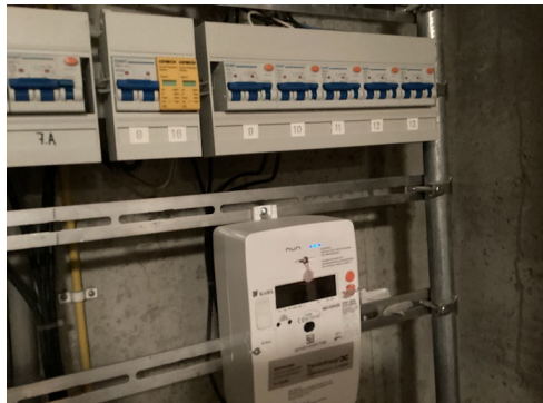
Bilde av sikringskap.
