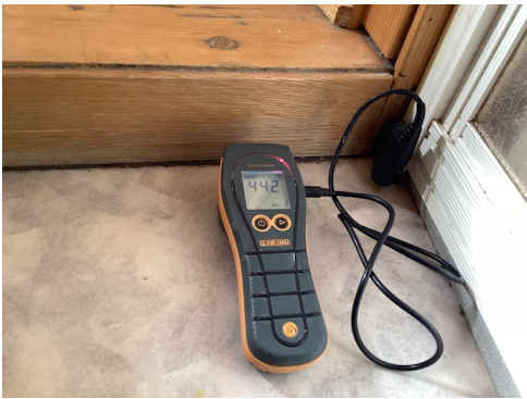
Bilde av fuktsøk i treverk ved dusjhjørne hvor det påvises forhøyde fuktverdier.
