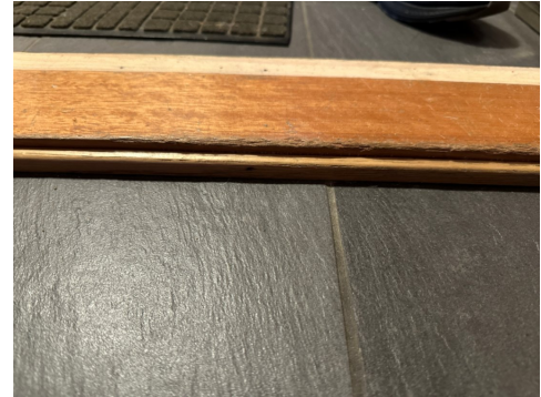
Overgang mot dørterskel.
