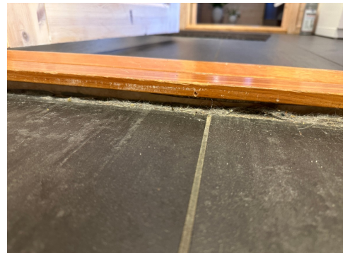
Overgang mot dørterskel.
