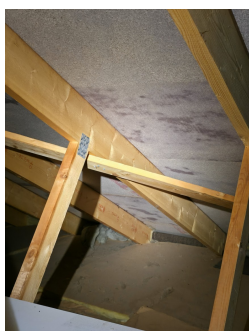
Misfarging/fuktskjolder i undertaksplater.
