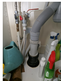
Rørgjennomføringer i benkeskap er utett.
