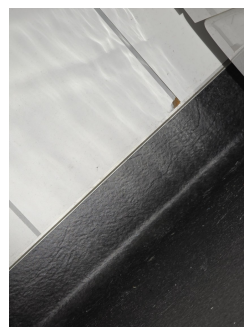
Fuge mangler mellom veggplater og sokkelprofil. Mindre støtskade i overflaten.
