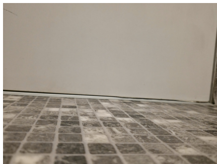
Utilstrekkelig luftespalte mellom gulv og dørrblad.
