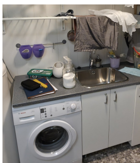
Våtsone for servant har ikke tettesjikt på vegg.
