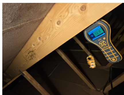
Fuktmåling i taksperre.
