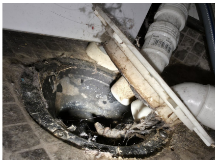
Sluk under benkeskap.
