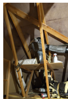
Delvis isolert ventilasjonskanal på mørkeloft.
