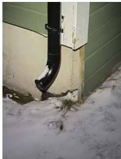
Taknedløp har vinklet utkast montert.
