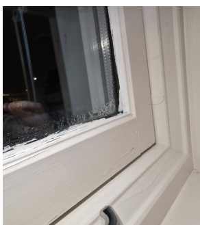
Synlig fukt på vindu i vaskerommet tyder på høy luftfuktighet.
