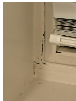
Påbegynte fuktskader i vindu plassert i våtsonen.
