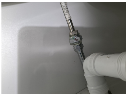
Irring på synlig rørkobling.
