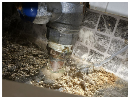
Rørgjennomføring i gulv (våtsone).
