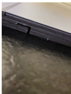
Ubeskyttet treverk i underkant av veggplater montert direkte på vegg.
