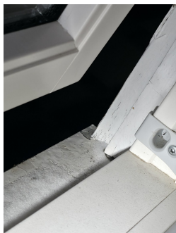
Omramming lagt ned på vannbrettet har ført til sprekkdannelse i treverket.
