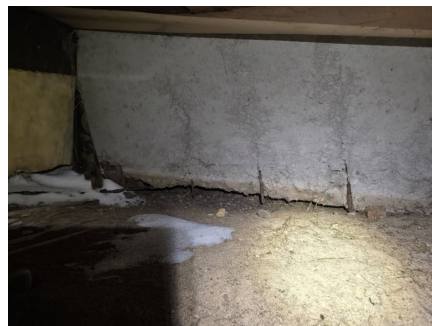
Synlig rustskader i armering og åpning mellom grunnmur og underliggende terreng
