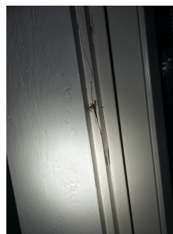
Mindre utvendig skade i vinduskarm.
