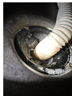
Rustskader i slukets metalledaljer.
