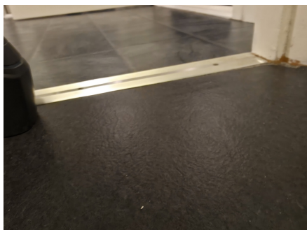
Gulvbelegg ved døråpning har ingen oppkant.
