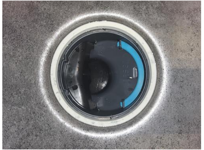
Membran, tettesjikt og overgang til sluk. - [Sluk på badetrom ]
