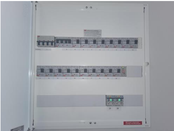
Elektrisk anlegg - [Sikringskap ]
