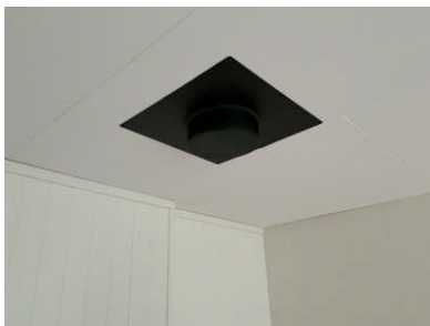
Pipe avsluttet i himling på stue i 1.etasje
