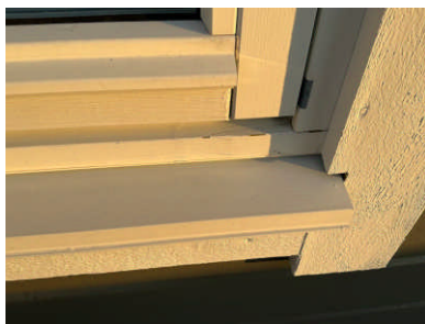
Det registreres værslitte karmen utvendig.
