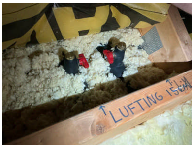
Lufteventiler til vannbåren varme.
