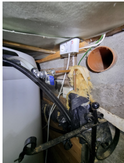
Bildet viser lufting sett fra kjeller. Kontroll ikke mulig.
