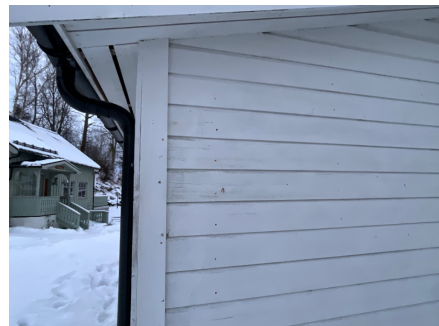
Bildet viser noe slitt overflatebehandling.
