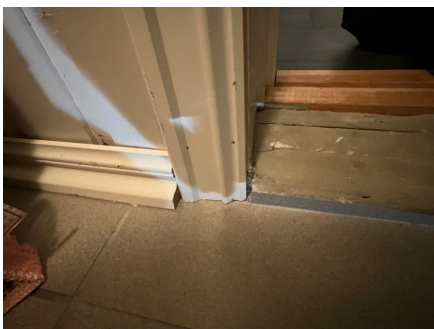
Bildet viser at vannsikkerheten er ikke ivaretatt med tilstrekkelig overhøyde på membran.
