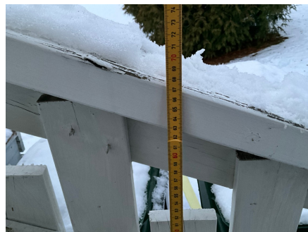
67 cm høyt rekkverk i utvendig trapp
