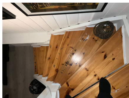
Manglende håndløper i innvendig trapp.
