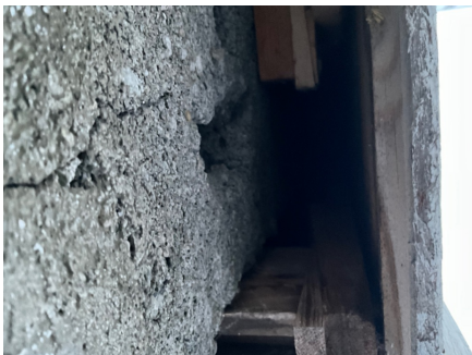
Det er ingen musesperre i nedre kant av konstruksjon ved hjørnekasse.
