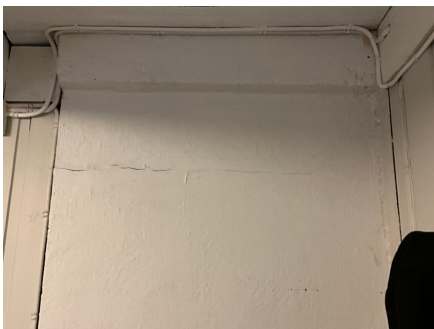
Sprekk i overflatebehandling
