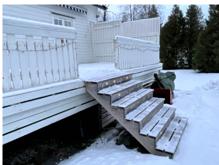
Manglende rekkverk utvendig trapp.
