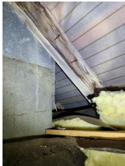
Bildet viser fuktskjolder og synlig forenklet undertak av plast.
