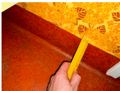
Løs tapet på vegger.
