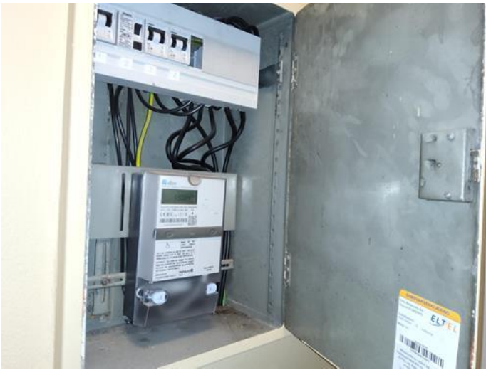
Elektrisk anlegg - [Sikringskap.]
