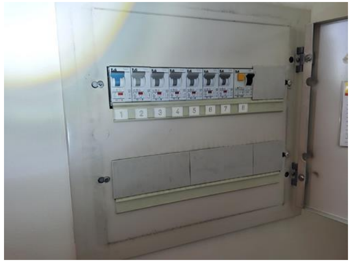
Elektrisk anlegg - [Sikringskap ]
