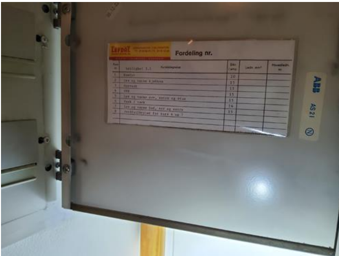
Elektrisk anlegg - [Kursoversikt ]
