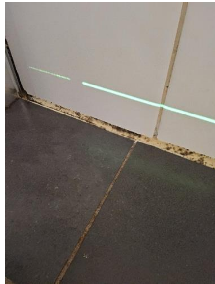
Våtrom - [Svertesopp i elastiske fuger.]
