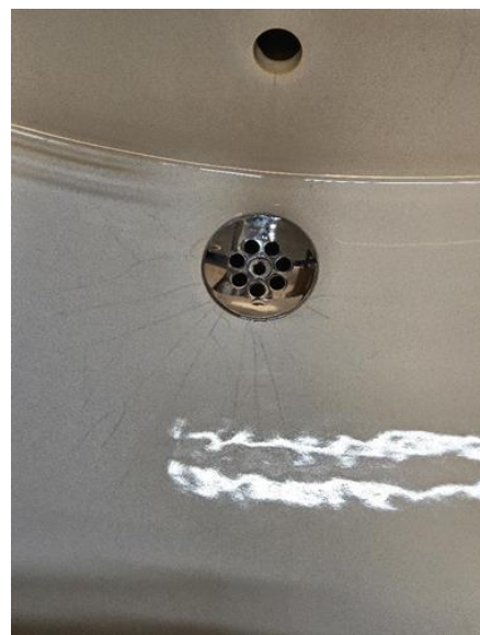
Våtrom - [Krackelering i porselen. ]
