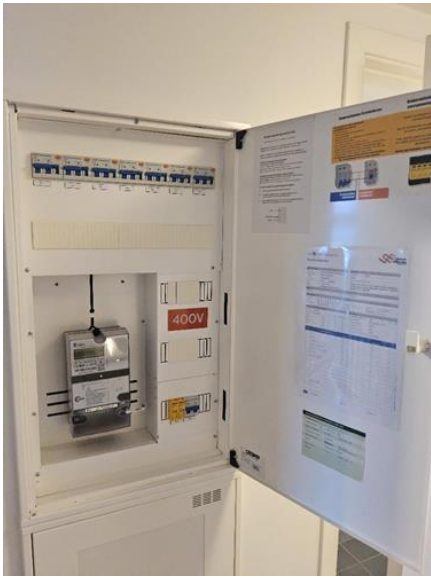
Elektrisk anlegg - [Sikringskap. ]
