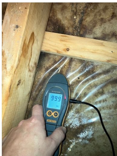
Bilde av fuktsøk over himling på bad.
