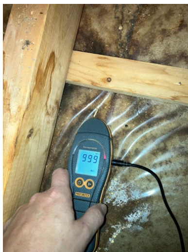
Bilde av fuktsøk over himling på bad.
