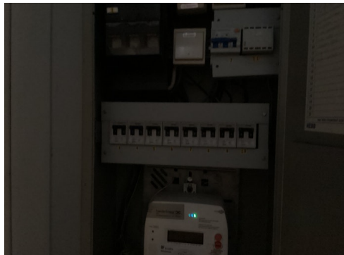
Bilde av sikringskap.
