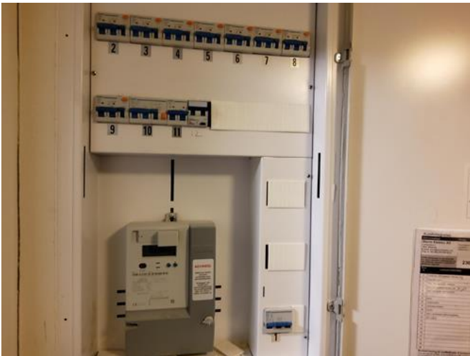
Elektrisk anlegg - [Sikringskap ]
