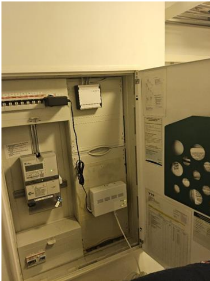
Elektrisk anlegg - [Sikringsskap. ]
