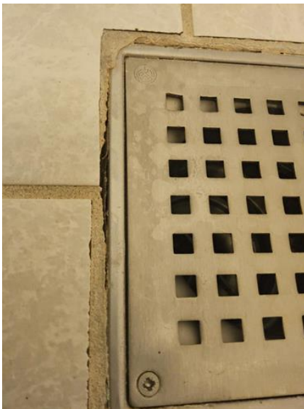
Våtrom - [Riss/sprekk i flisefuger ved sluk i dusjsonen. ]
