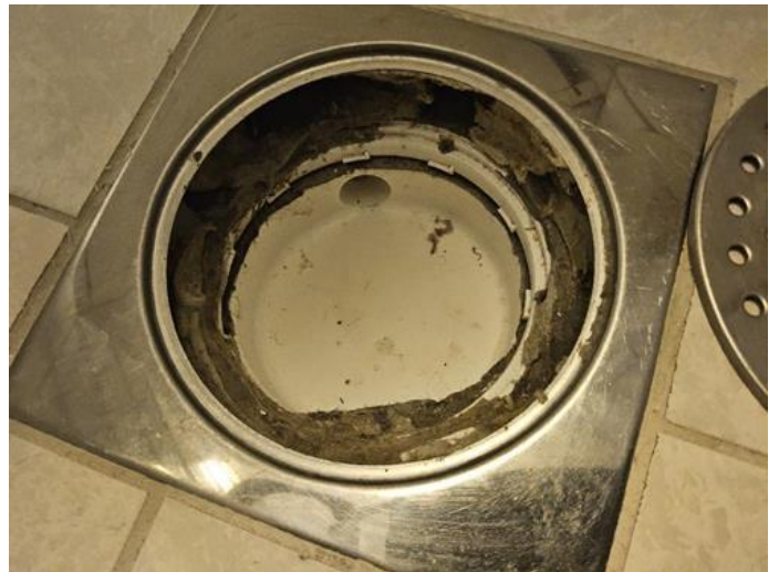
Våtrom - [Sluk på bad (hjelpesluk).]
