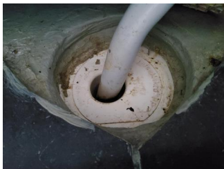
Avløp (inkl. sluk) - Sluk bad 2.etg
