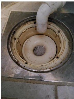
Avløp (inkl. sluk) - Sluk bad 1.etg.
