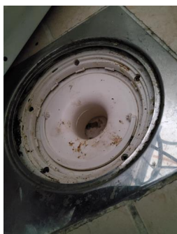
Avløp (inkl. sluk) - Sluk bad underetasje.
