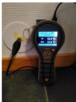
Utført kontroll i tilliggende konstruksjon - Fuktmåling bad underetasje.
