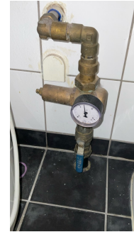
Hovedstoppekrane med redusjonsventil
