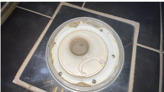
Smøremembran/mansjett er ført ned under skrudd klemring på plastsluken.
