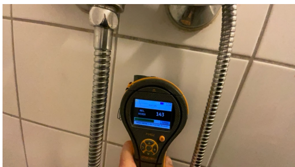
Fuktsøk er utført på vegg i dusj mot yttervegg under dusjbatteri. Ingen forhøyde fuktavvik er målt
