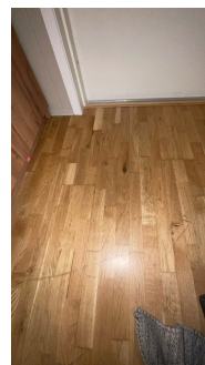
Slitasje på parkett i gang ved hoveddør i hovedleiligheten.
