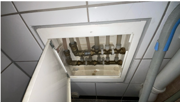
Fordelingsskap i hovedleiligheten er ikke merket
