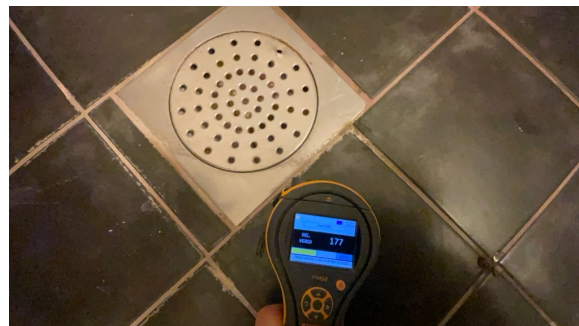
Noe forhøyet fuktverdier ved sluk, det er opplyst fra hybelboer at dusjen var i bruk kvelden før befaringen noe som påvirke målingen.
