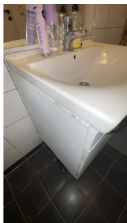
Fuktskade/svelling på side av servantskap mot dusj
