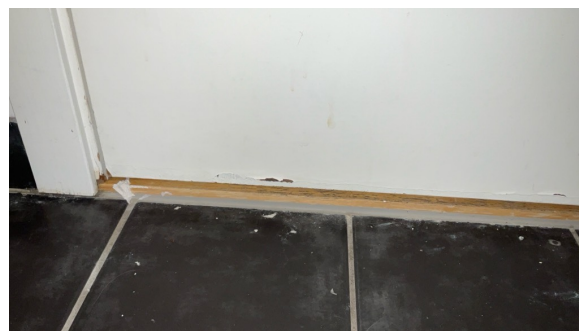
Luftespalte under dør er for liten. Målt til ca. 6 mm.
