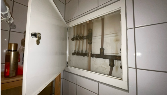
Fordelingsskap hybel er ikke merket
