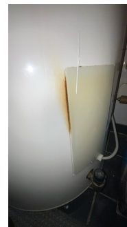
Varmemerker i tank ved deksel til elektriske tilkoblinger
