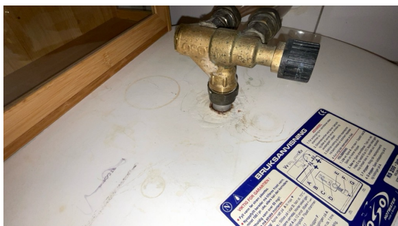
Rust rundt rør til blandeventil
