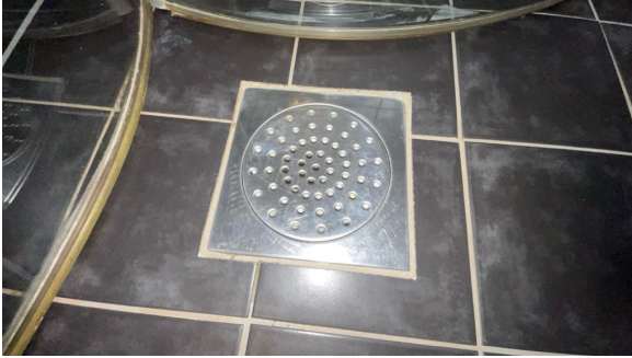
Noe slitasje på fuger i dusj
