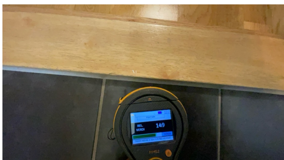
Fuktsøk er utført på gulv ved dør. Ingen forhøyde fuktavvik er målt
