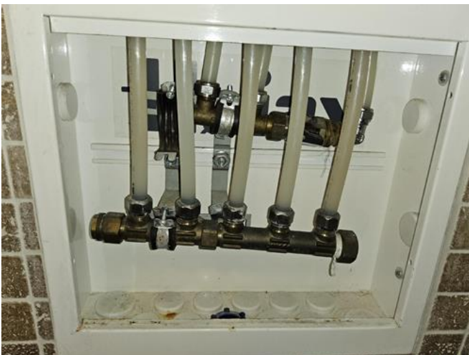
Tekniske anlegg, VVS anlegg (Sjekkpunkter utover det som er inkludert i andre rom) - [Fordelerskap bad underetasje ]
