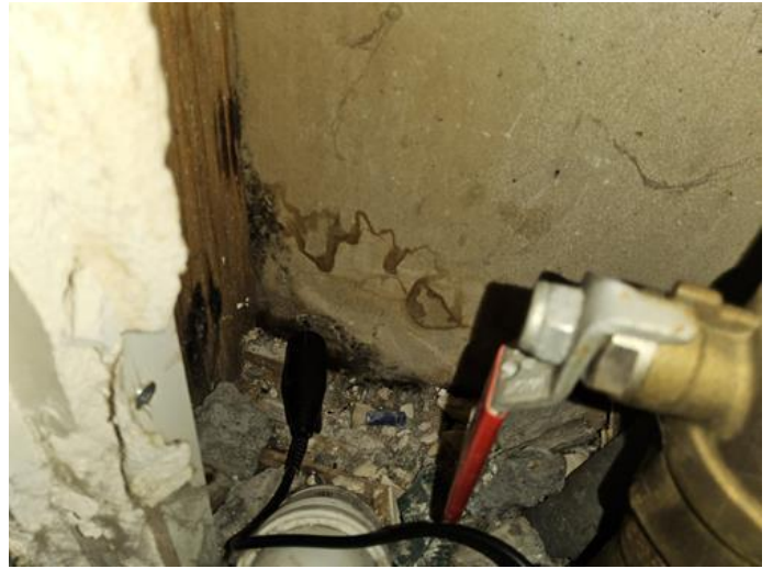
Kommentar - [Fukt, svertesopp tilstøtende rom bad underetasje ]
