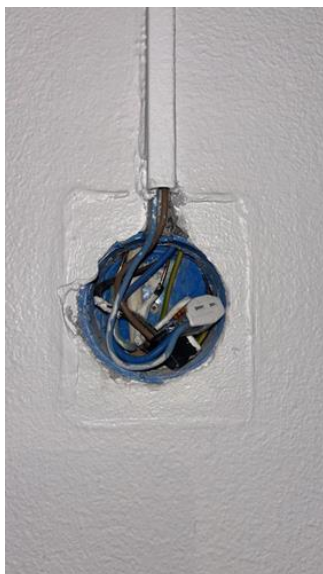
Elektrisk anlegg - [Mangler dekklokk, soverom 1]
