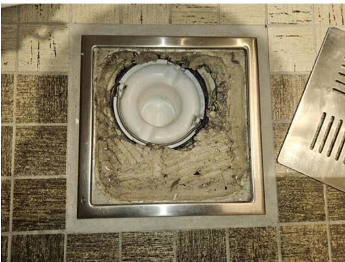
Avløpsrør (ink. sluk) - [Sluk bad 1.etasje ]
