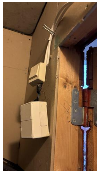
Elektrisk anlegg - [Løs kabel, bryter bod]
