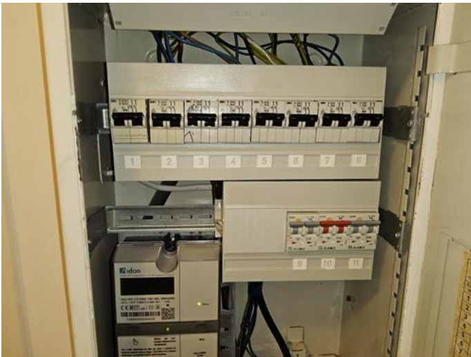
Elektrisk anlegg - [Sikringskap ]
