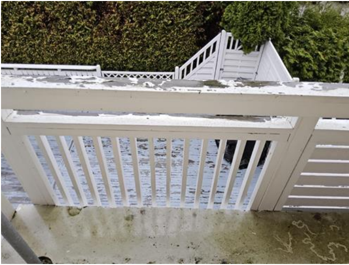
Kommentar - [Rekkverk balkong ]
