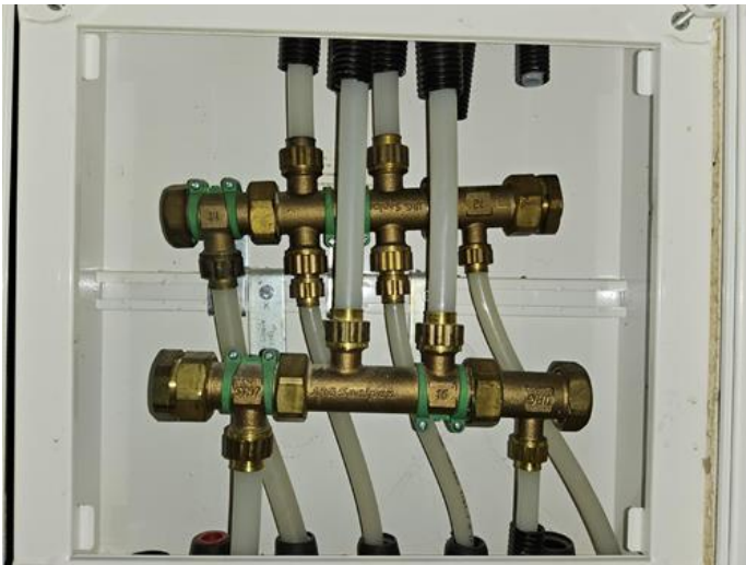
Tekniske anlegg, VVS anlegg (Sjekkpunkter utover det som er inkludert i andre rom) - [Fordelerskap rør-i-rør ]
