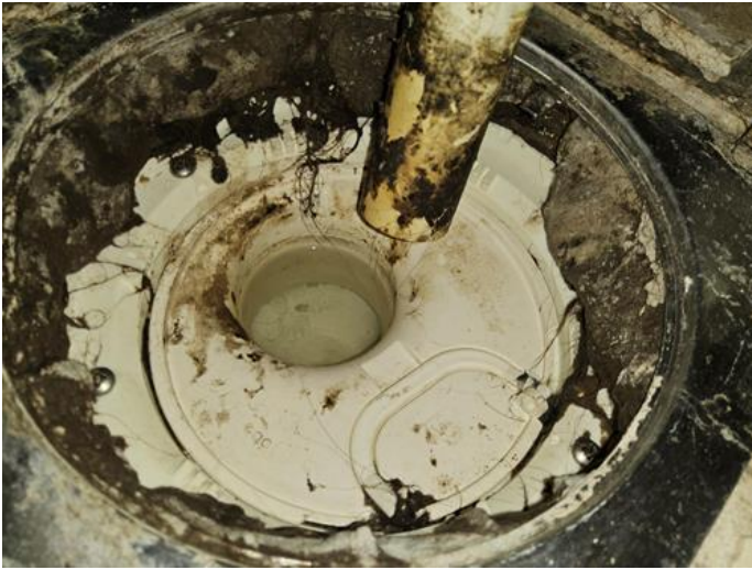
Membran, tettesjikt og overgang til sluk. - [Sluk bad underetasje ]
