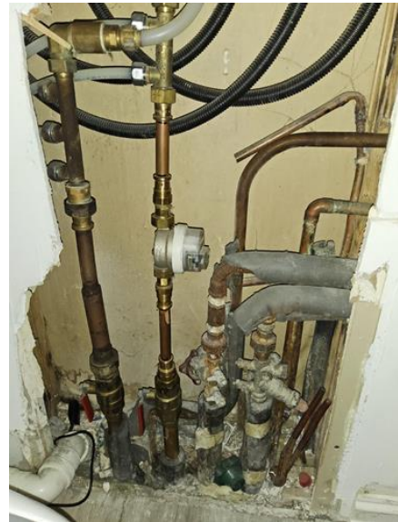
Tekniske anlegg, VVS anlegg (Sjekkpunkter utover det som er inkludert i andre rom) - [Røropplegg med hovedstoppekran ]
