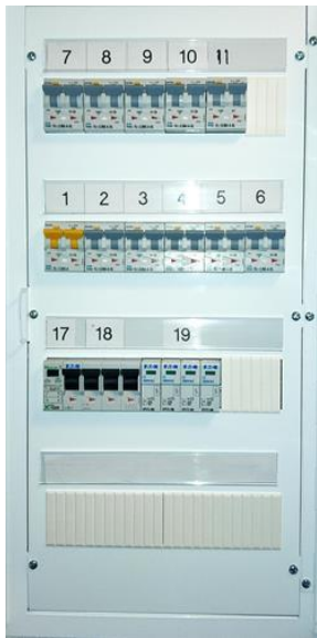
Forenklet vurdering av det elektriske anlegget - [Sikringskap]
