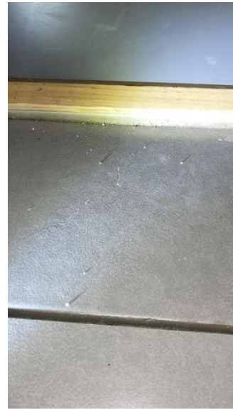
Overflater gulv - [Sprekke i gulvflis ved ytterdør]
