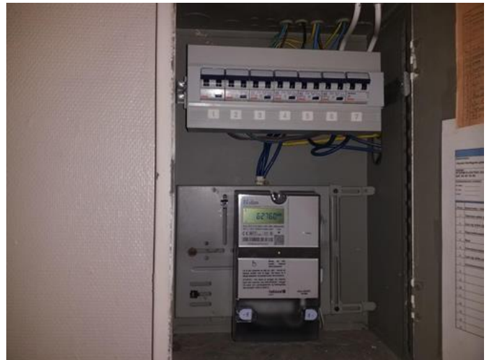
Elektrisk anlegg - [Sikringsskap. ]
