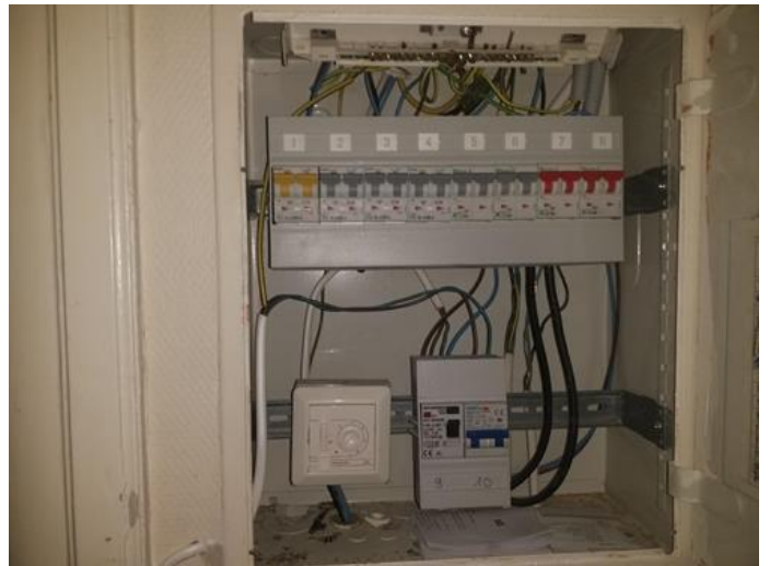
Elektrisk anlegg - [Sikringsskap. ]
