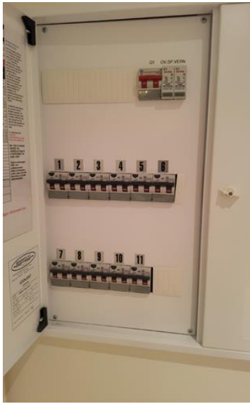
Elektrisk anlegg - [Sikringskap ]
