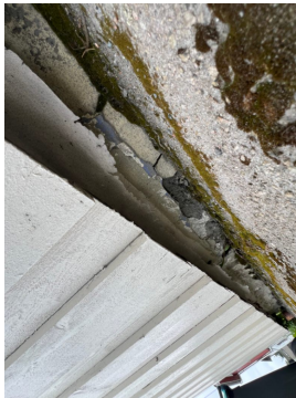
En del sprekker i mur på synlige steder.
