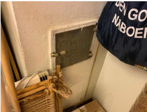
Sotloke nært treverk
