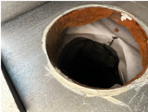
Ikke skadedyrs netting i ventilasjons åpning
