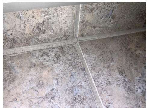
Sprekker i flisfuger og ujevnt - ufagmessig monterte fliser.
