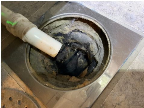
Utett våt veggzone
