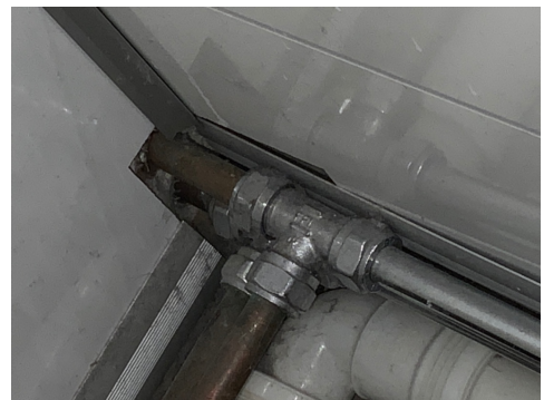
Stedvis irr og ikke kondenssikrede gjennomføringer.
