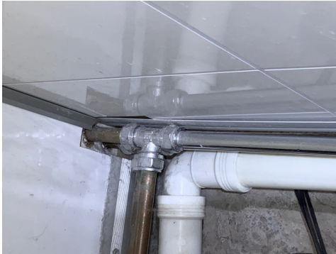
Ufagmessig montasje av vegg/baderomsplater - utett løsning. Ikke kondenssikret vannrør.
