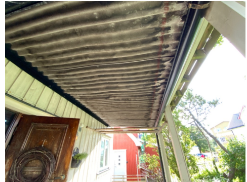
Deformasjon i tekke - dryppstop under balkong
