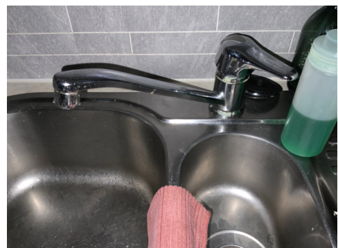
Blandebatteri er løst har en del slitasje og står for skifte
