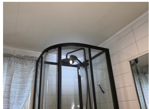
Dusj er plassert nært tak/ikke fuktbestandig materiale
