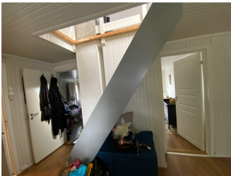
Veldig bratt loftstrapp som mangler rekkverk
