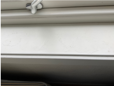
Fuktskjolder- svellemerker i vinduskarm
