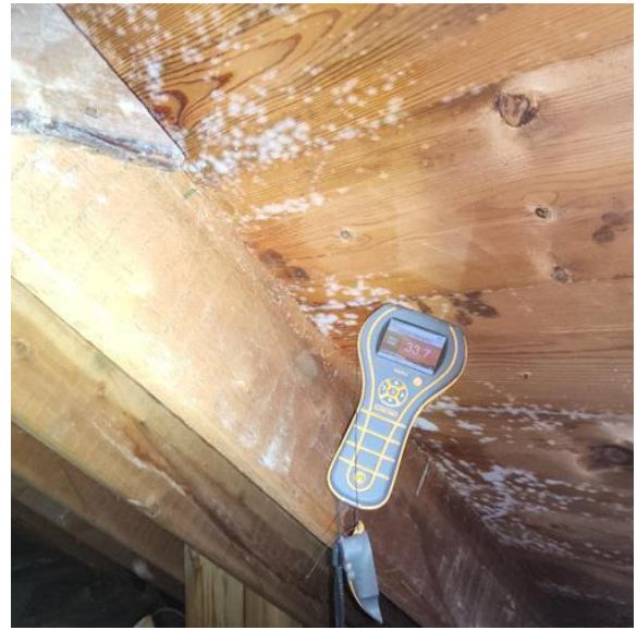
Innvendig - [Eksempel på fuktmåling og soppvekster på loft]
