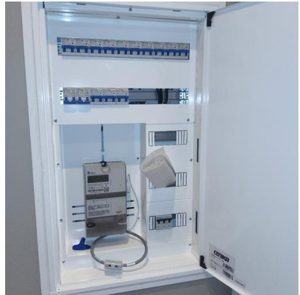
Elektrisk anlegg - [Sikringskap]
