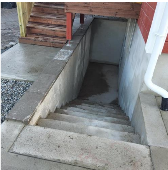
Utvendig - [Kjellernedgang med manglende rekkverk]
