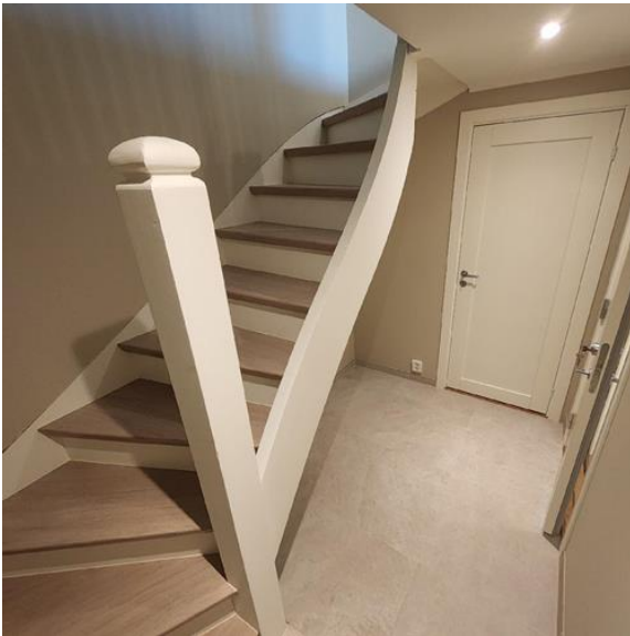
Innvendig - [Trapp med manglende rekkverk til kjeller]
