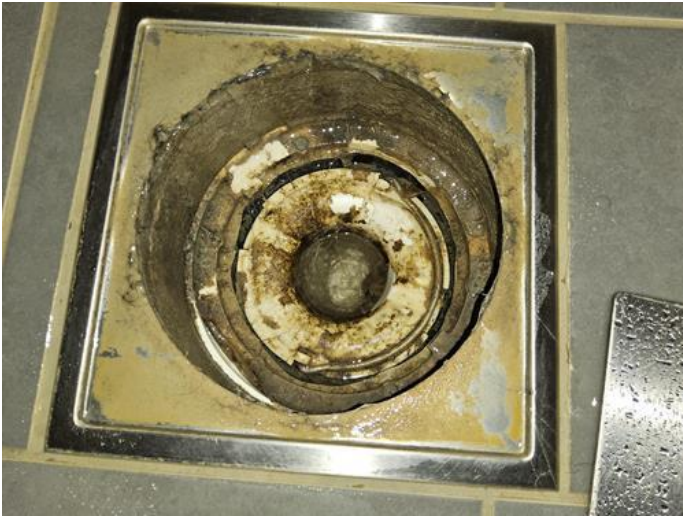
Avløpsrør (ink. sluk) - [Sluk bad 2.etasje ]
