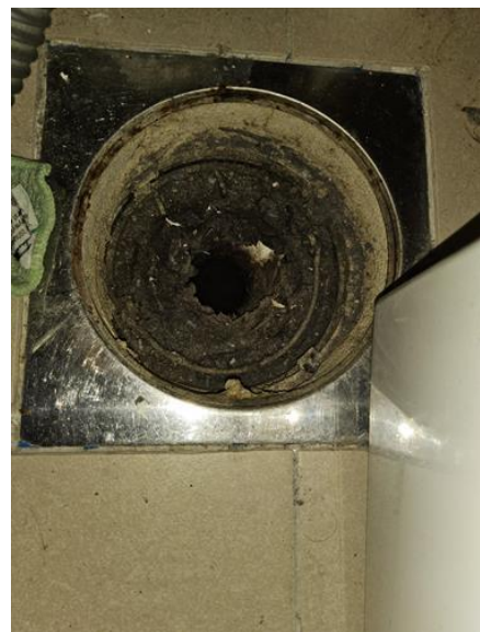
Avløpsrør (ink. sluk) - [Sluk vaskerom ]
