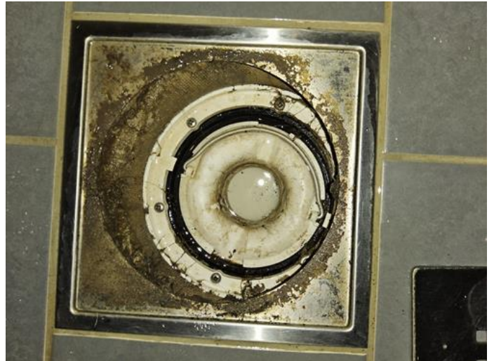
Avløpsrør (ink. sluk) - [Sluk bad 1.etasje ]
