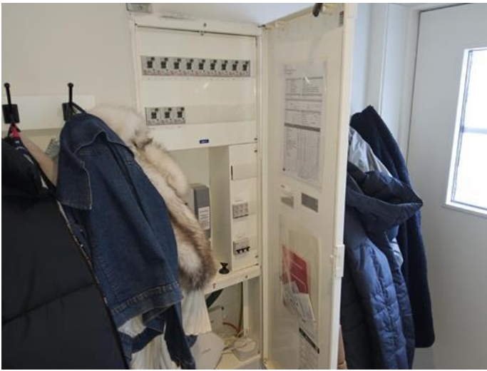
Elektrisk anlegg - [Sikringskap ]
