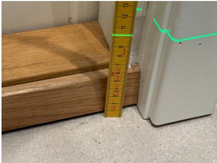
Fallforhold ca. 101 mm overkant gulv ved terskel
