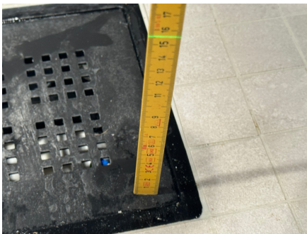
Fallforhold ca. 155 mm topp slukrist i dusjsone
