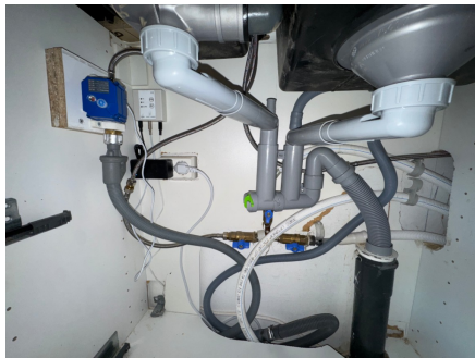
Rørlegging og lekkasjevarsler i kjøkken
