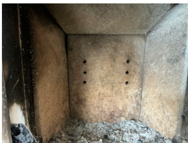
Det registreres sprekk i ildfast stein inne i vedovn.
