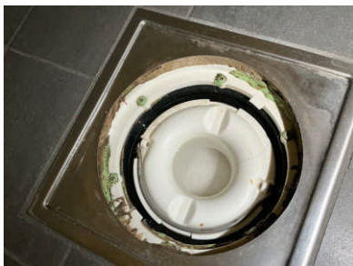
Sluk i dusjsone.
