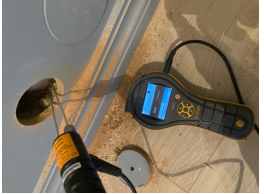
Fuktmåling i vegg mot våtsone servant fra tilstøtende soverom.
